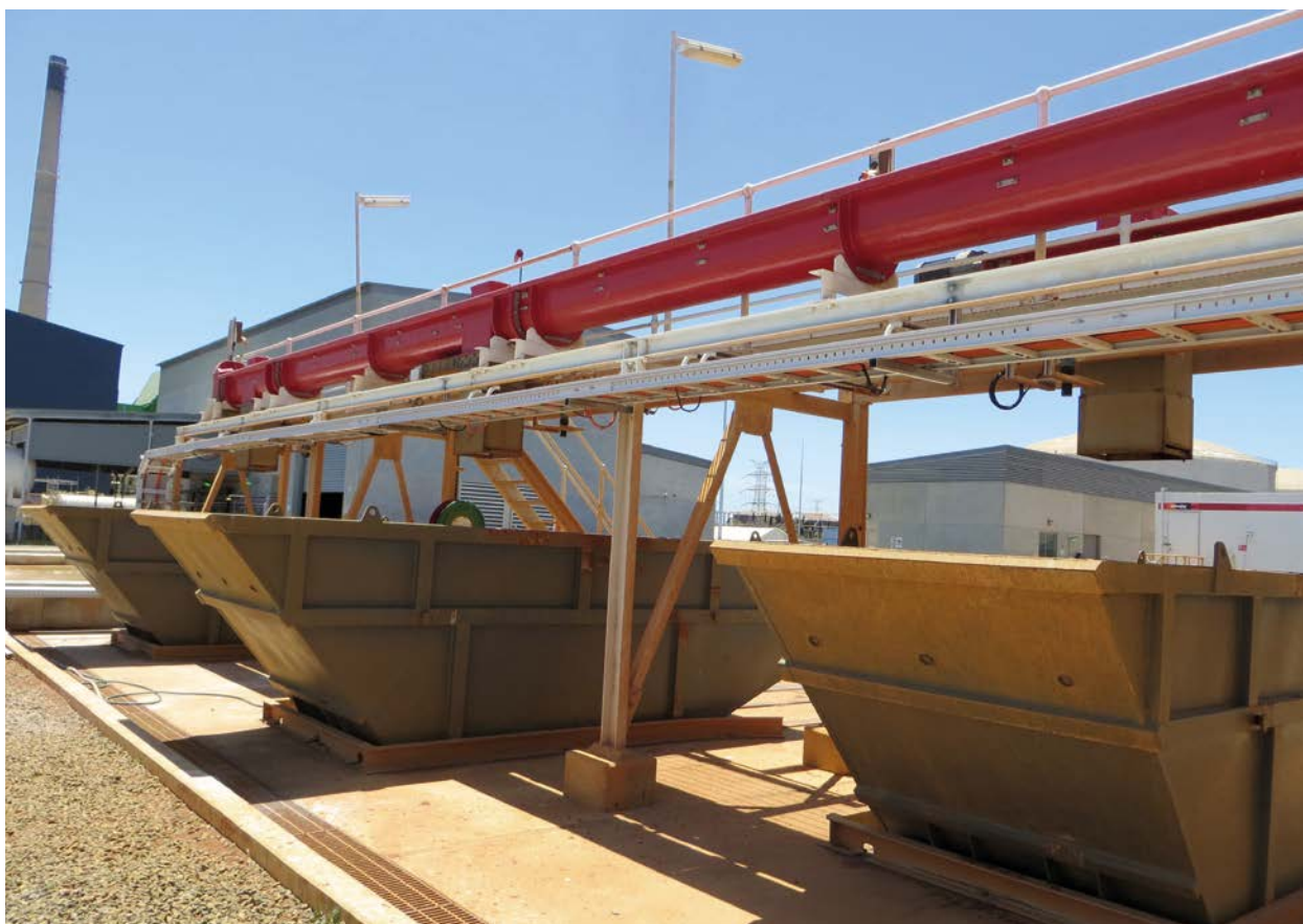
Trattamento acqua: impianto desalinizzazione
