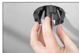
Applicazione a soffitto.
