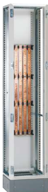
▲ sistema barre 250-630 A verticale inclinato installato sul fondo delle strutture L435
