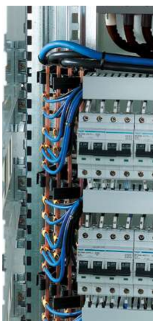
▲ sistema barre 250 A verticale / laterale installato sul lato sinistro delle strutture
