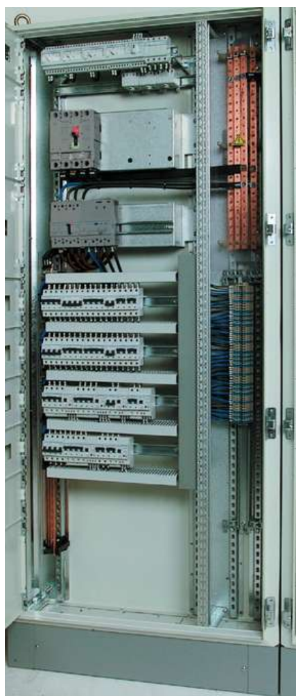
▲ sistema barre 250-400 A orizzontale/verticale installato in verticale nel vano L170 delle strutture L885, P260 e P400
