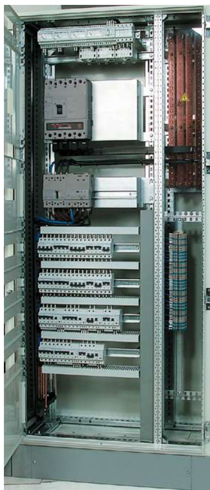
▲ sistema barre 250-400 A orizzontale/verticale installato in verticale nel vano L170 delle strutture L885, P400
