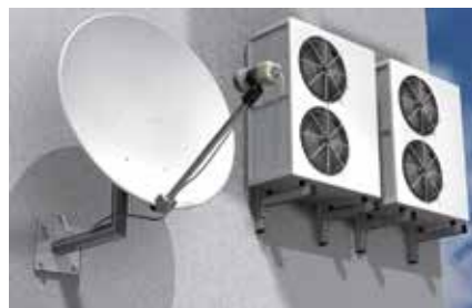
Antenne paraboliche e condizionatori
