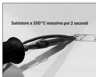
Figura 4. Saldatura dei cavi Utilizzare stagno senza piombo
