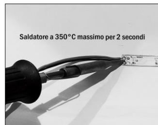
Figura 4. Saldatura dei cavi. Utilizzare stagno senza piombo
