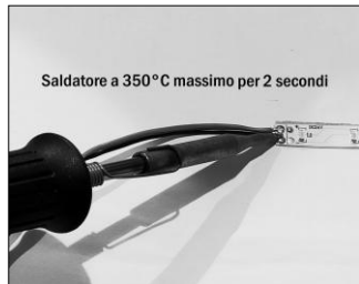
Figura 4. Saldatura dei cavi Utilizzare stagno senza piombo
