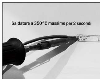
Figura 4. Saldatura dei cavi Utilizzare stagno senza piombo
