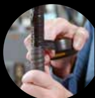
Isolamento dei cavi ponte
